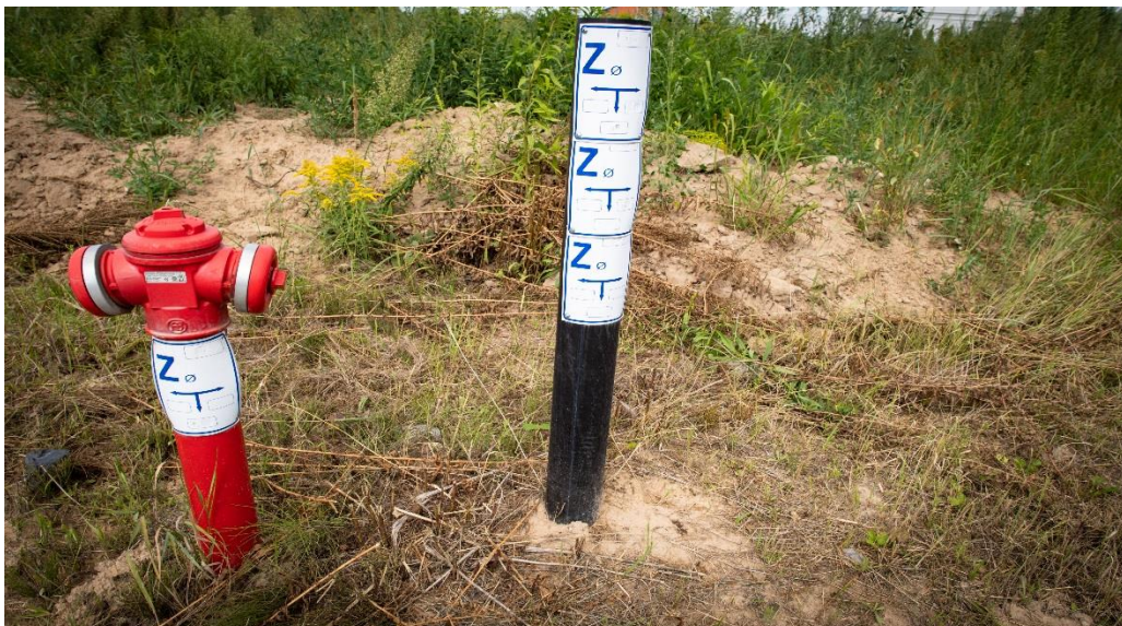
Lokalna infrastruktura wodociągów
